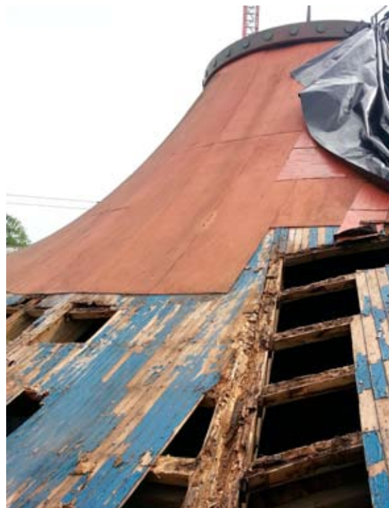
De bestaande dakconstructie van het koepeldak in Slagharen was ernstig aangetast door vocht.
